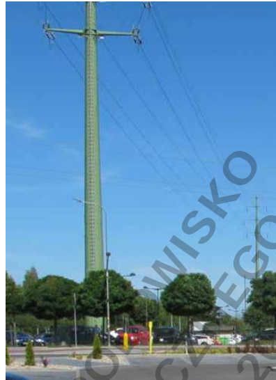
Fot. 8. Linia elektroenergetyczna wysokiego napięcia przebiegająca wzdłuż ulicy Starogardzkiej
