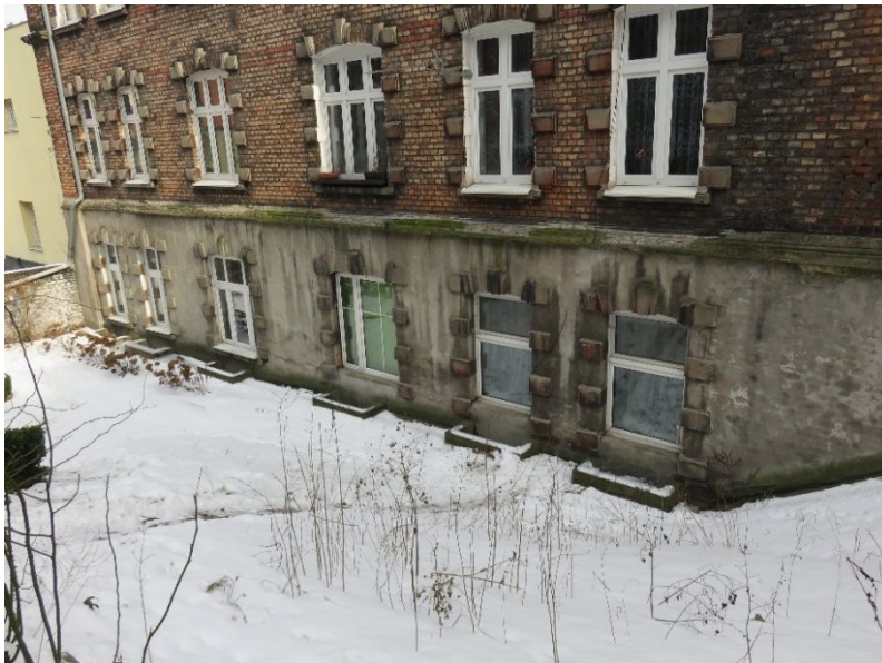
widoczne odparzenia, spore zawilgocenia i zabrudzenia w tynku na cokole na elewacji frontowej
