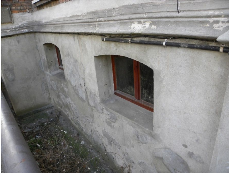
widoczne odparzenia w tynku na cokole na elewacji frontowej
