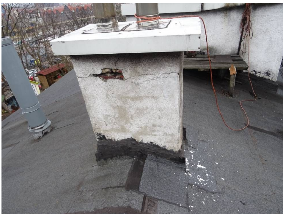
10. Widok stanu kominów
