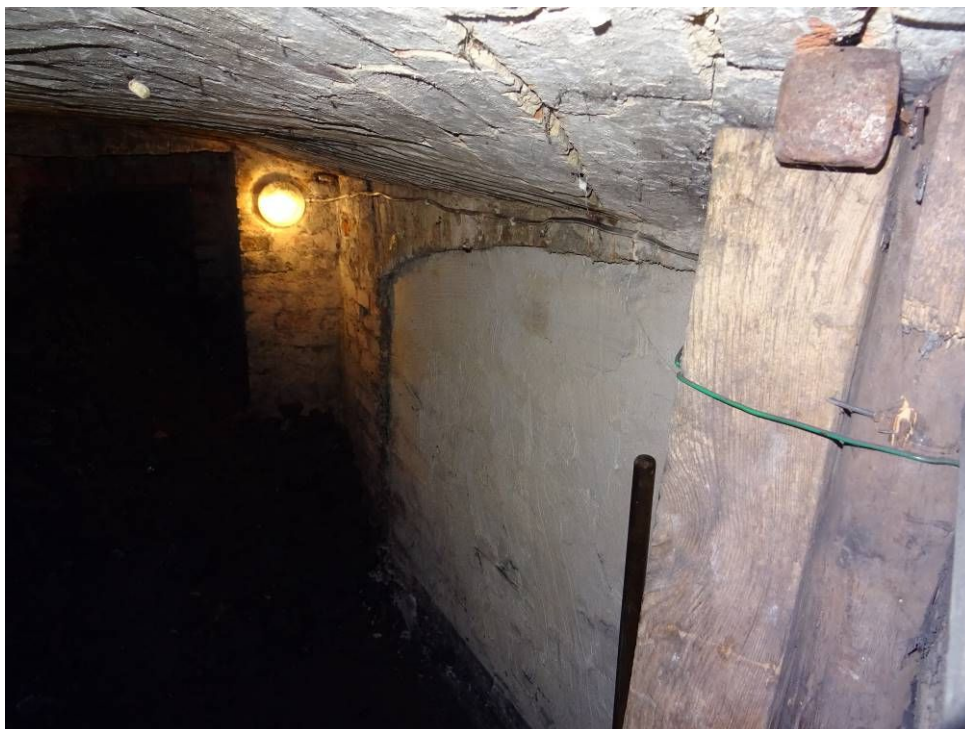
11. Widok zawilgoceń ścian fundamentowych w piwnicy
