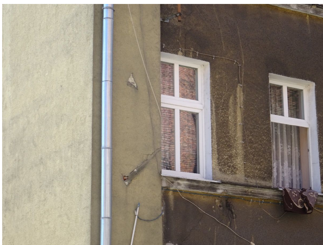
4. Pas ocieplenia do usunięcia wraz z przywróceniem gzymsu
