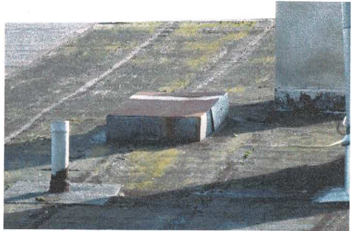
Uszkodzenia pokrycia dachu i wyłazu.
