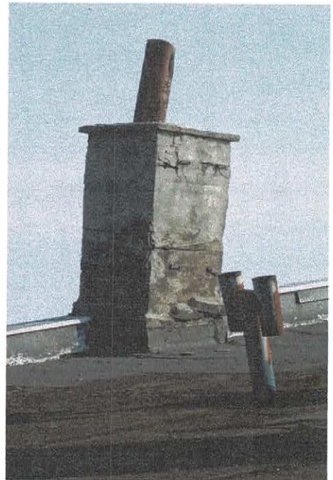
Uszkodzenia kominów i kominków z blachy.
