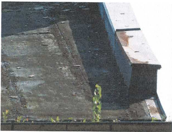
Uszkodzenia dachu i obróbek
