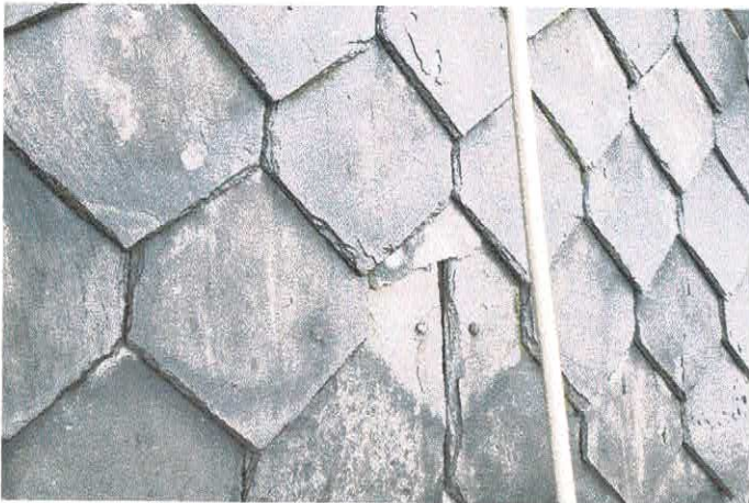
Uszkodzenia pokrycia dachu z łupka
