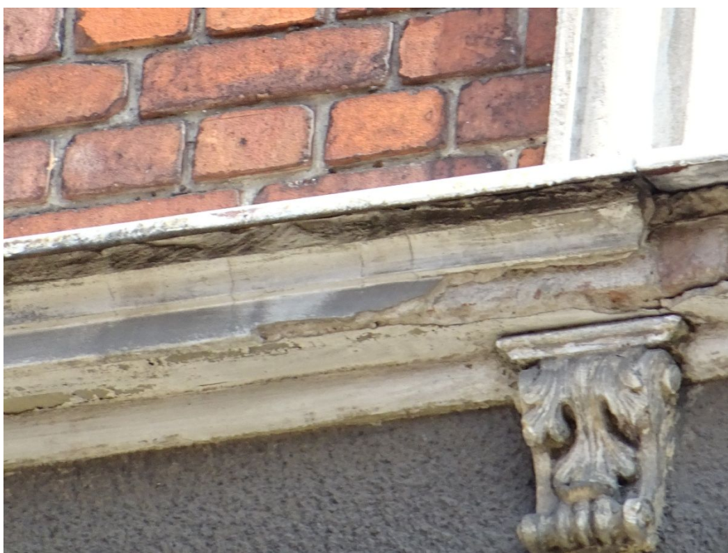
8. Widokubytku na gzymsie
