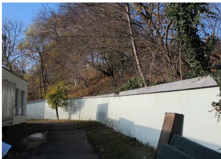
Fot. 11. Ściana oporowa podpierająca podcięte, północne zbocze doliny Potoku Siedleckiego w rejonie lecznicy dla zwierząt (teren 01-M/U31).
